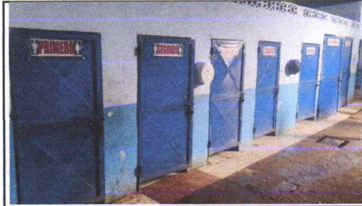
FOTO 2: Mantenimiento a estructura (lijado, cambio de tubo , cepillado, sujeciones, aplicación de pintura) a puertas servicios sanitarios
